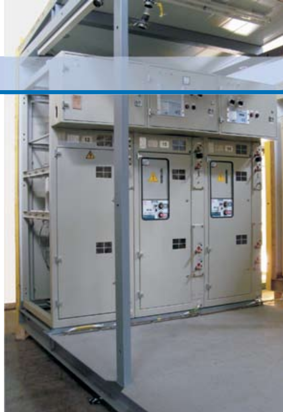
ЗРУ на базе КСО-202ВМ
