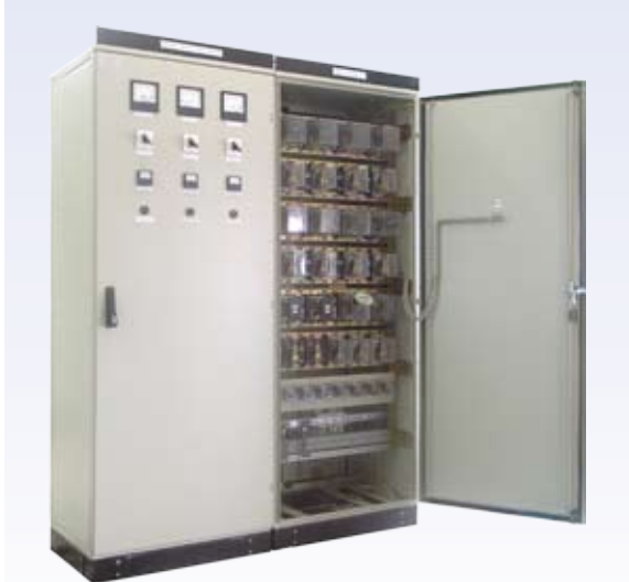
Устройства РЗА на базе реле
